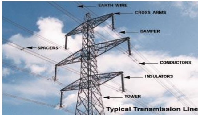
Gambar 6.2. Saluran transmisi udara
