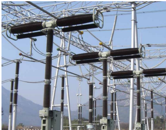
Gambar 6.9. Circuit Breaker Tegangan Tinggi
